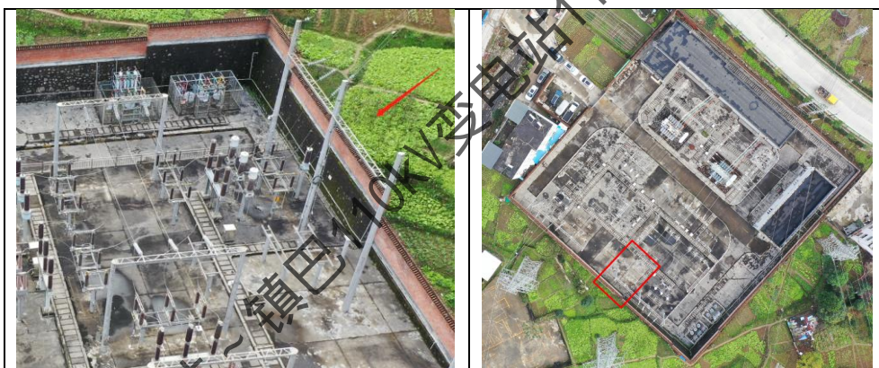
图 2-2 镇巴变电站现状照片
